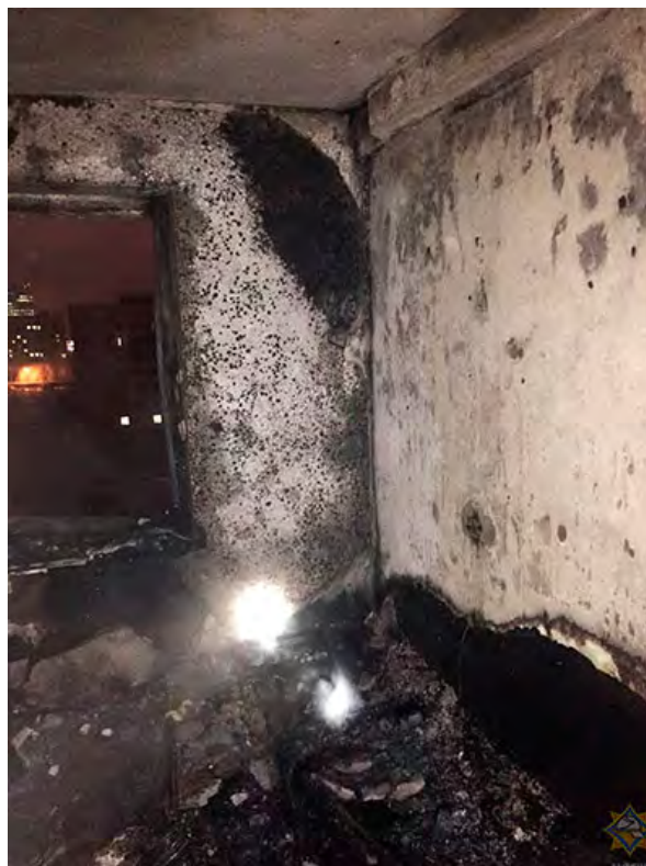
После пожара комнате понадобился ремонт
